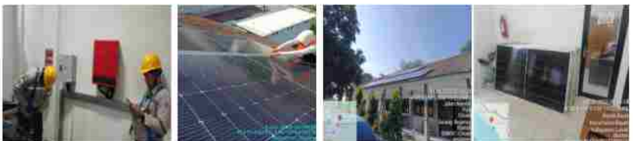
Pemasangan PLTS Atap di Gedung SMKN 1 Cikande Provinsi Banten, Pemasangan PLTS Atap di Gedung SMKN 1 Ciruas Provinsi Banten, Pemasangan PLTS Atap di Gedung SMKN 2 Pandeglang Provinsi Banten, Pemasangan PLTS Atap di Gedung SMKN 1 Bayah Provinsi Banten
